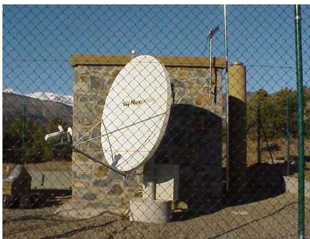
Antena de comunicació per satèl·lit.
