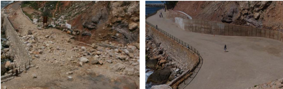
Risc de caiguda de roques. Situació d'abans i situació de després de l'actuació efectuada. Passeig del Molinet a l'Estartit.
