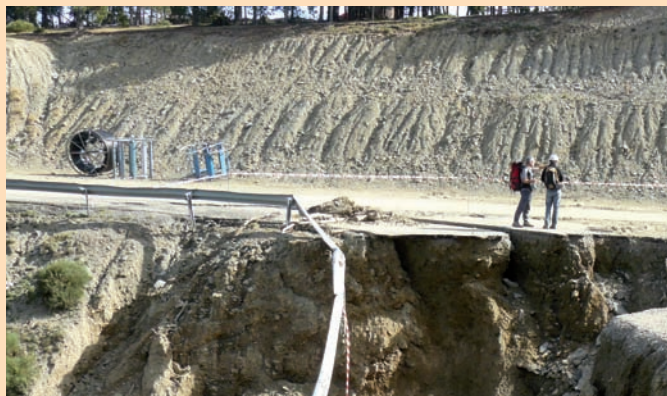
Danys a la carretera de l'estació d'esquí de Port-Ainé a causa de la torrentada del dia 12 de setembre de 2008
