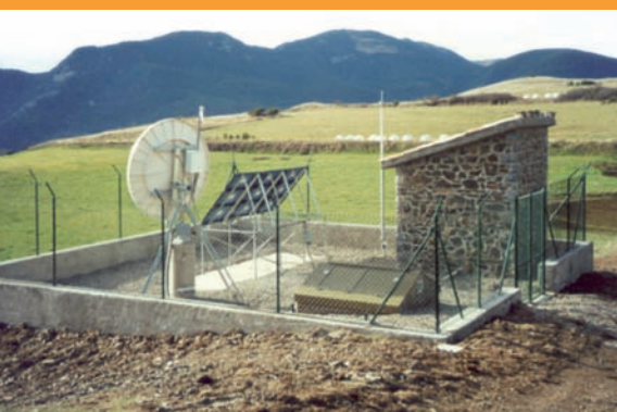
Estació sísmica de Bruguera (Ripollès), on s'observen diferents elements: pou pel sensor sísmic, caseta per a la instrumentació, panells solars i antena VSAT
