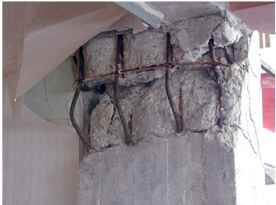
Vinclament de l'acer longitudinal com a conseqüència de la plastificació de marcs excessivament espaiats.
