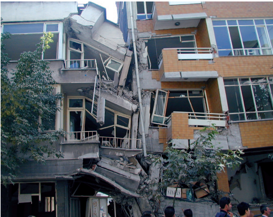
Pèrdua parcial de secció dels pilars de formigó armat, producte de la percussió entre edificis. Terratrèmol d'Izmit, Turquia, 1999.
