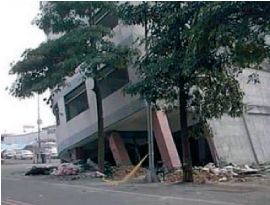
Combinació d'efectes torsionals i de planta baixa dèbil. Terratrèmol de Chi-Chi, Taiwan, 1999. Font: USGS.
