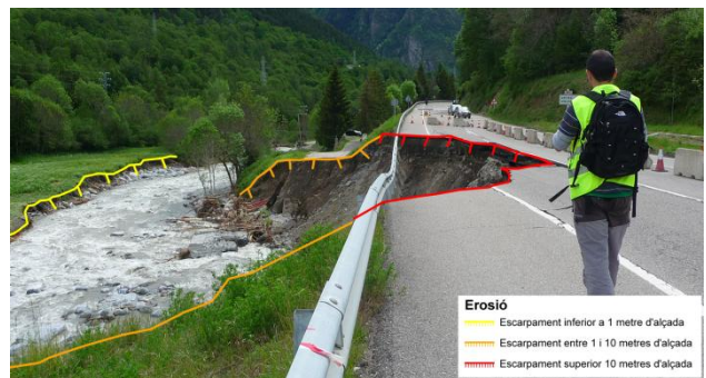
Figura 4 – Fotografia de la soscavació a la carretera C-28, PK 32+200, Gessa (Naut Aran) on s'exemplifiquen els escarpament cartografiats (IGC, 20/06/2013).
