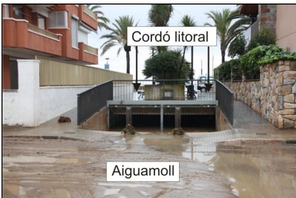
Figura 5 – Fotografia dos dies després de l'aiguat del 24 d'octubre del 2011 al barri de la Salut. S'observa que el barri (aiguamoll) queda deprimat respecte del passeig marítim (cordó litoral) i que el pas subterrani d'evacuació de l'aigua pot quedar molt fàcilment bloquejat per l'onatge i les aigües subsuperficials (Foto: Glòria Furdada).
