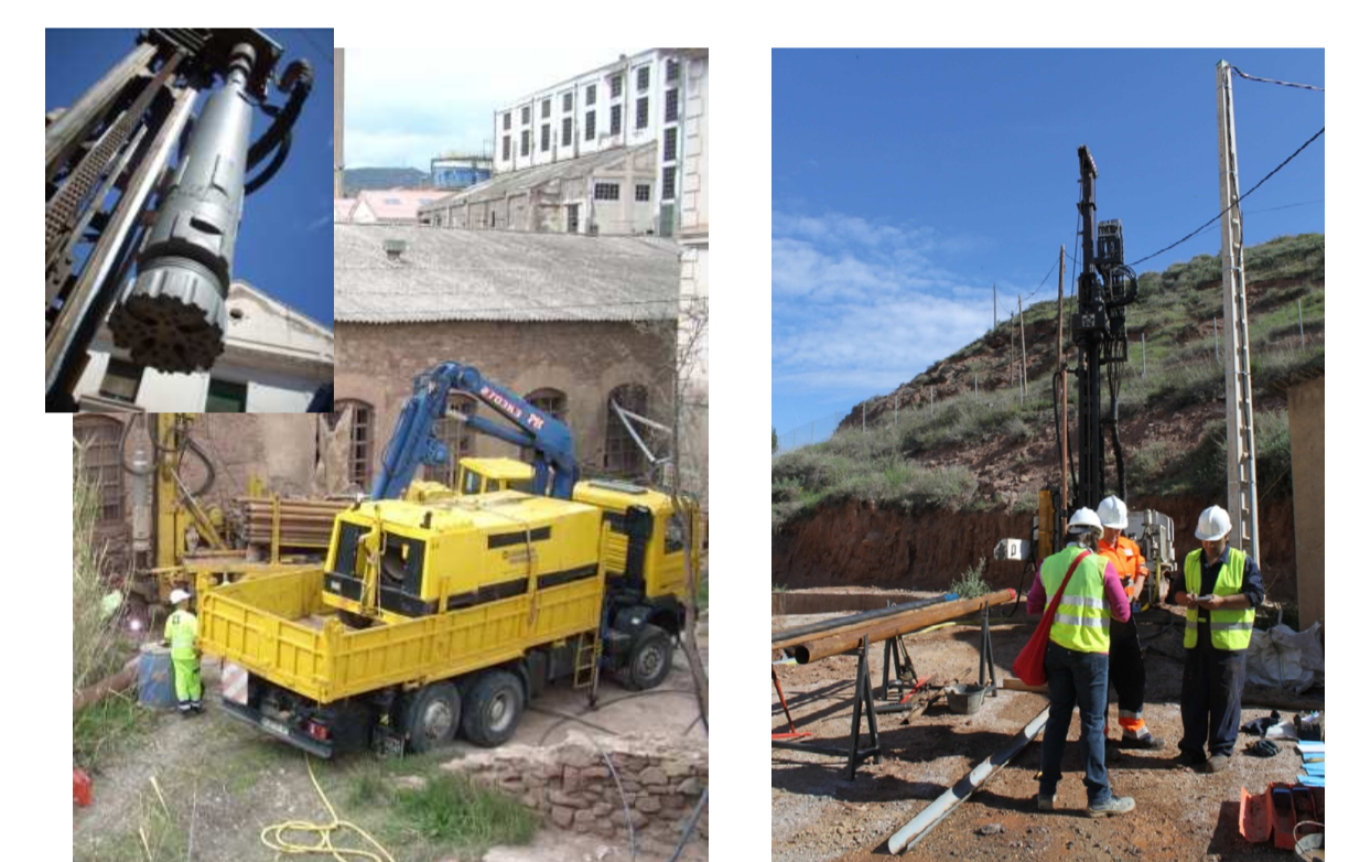
Figura 4: Construcción de piezómetros y pozos e implementación de un sistema de monitorización.
