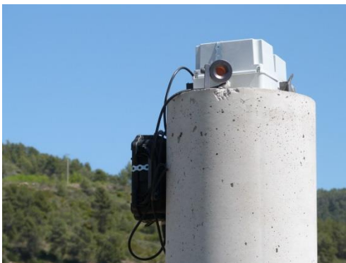
Wi-Gim. Sistema Wi-Gim instal·lat al Barri de l'Estació de Sallent per a la monitorització de la subsidència.
