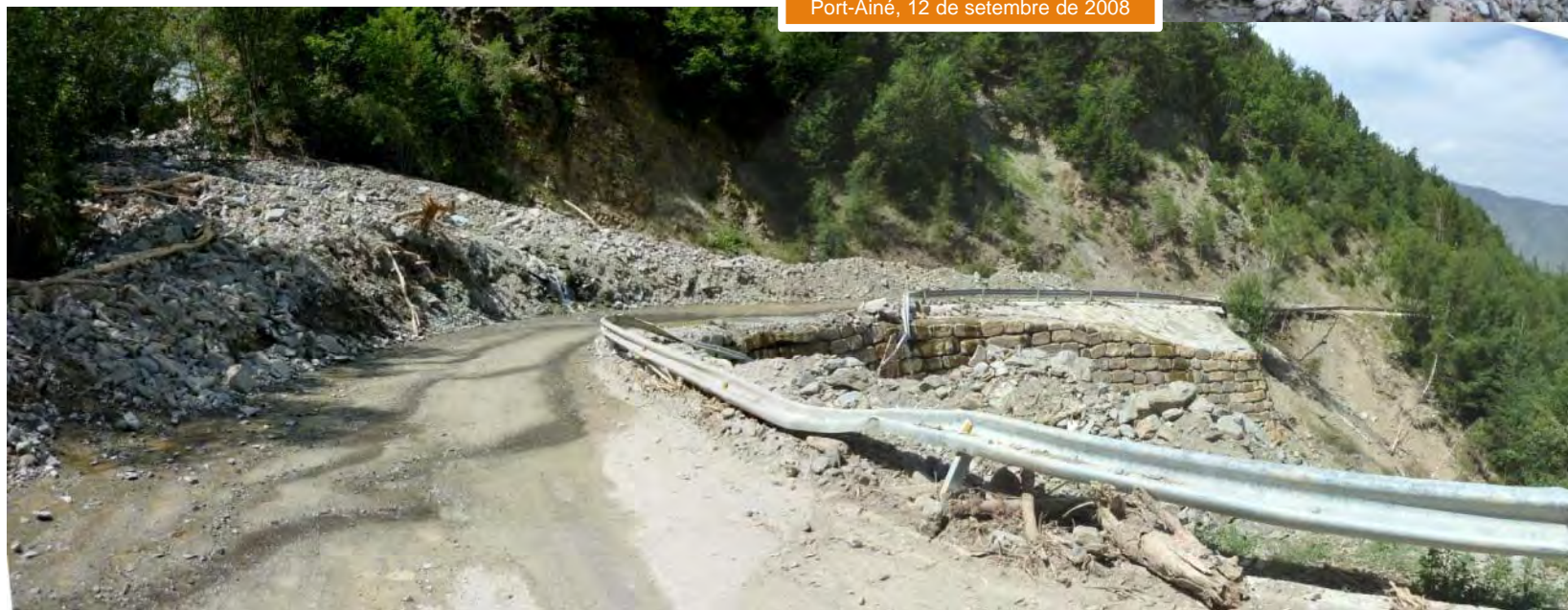
Danys a la carretera d'accés a les pistes d'esquí de Port-Ainé després de les pluges del 23 de juliol de 2010
