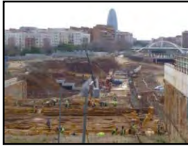
Condicions del terreny en excavacions
