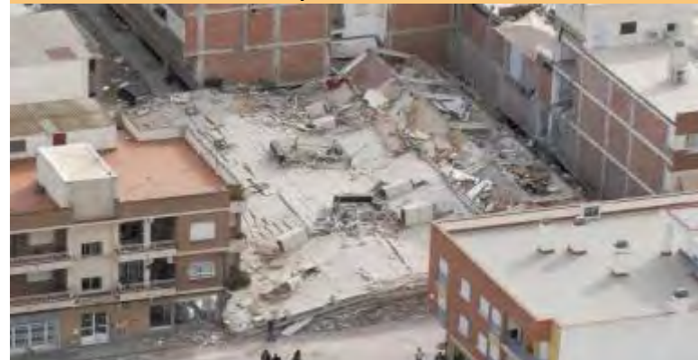
Col·lapsa en el terratrèmol M5.1 (2011)
