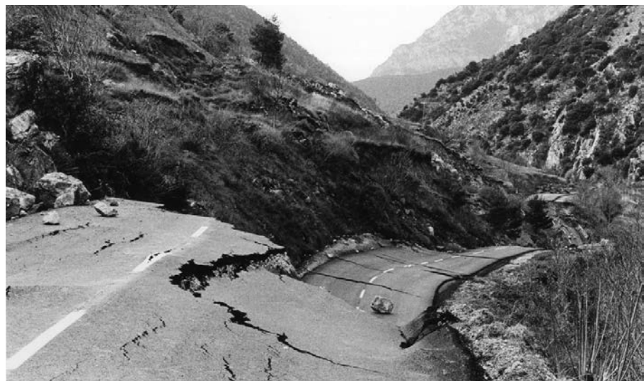
Figura 2.41. Desperfectos en la carretera C-1313 como consecuencia del deslizamiento del Pont de Bar. Autor desconocido.
